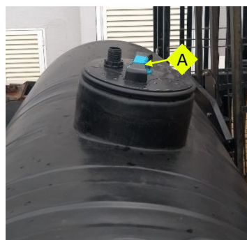
Respiro está localizado na tampa dos reservatórios
